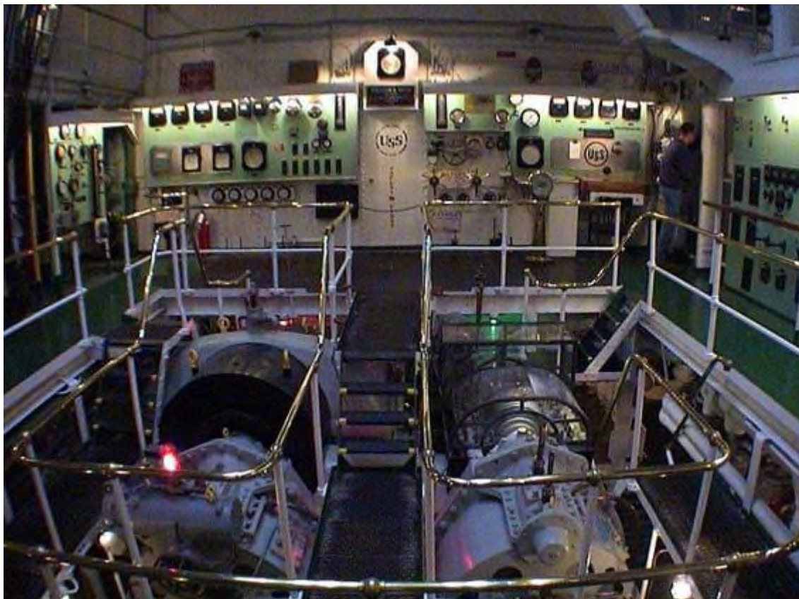
Bild från maskinrummet
