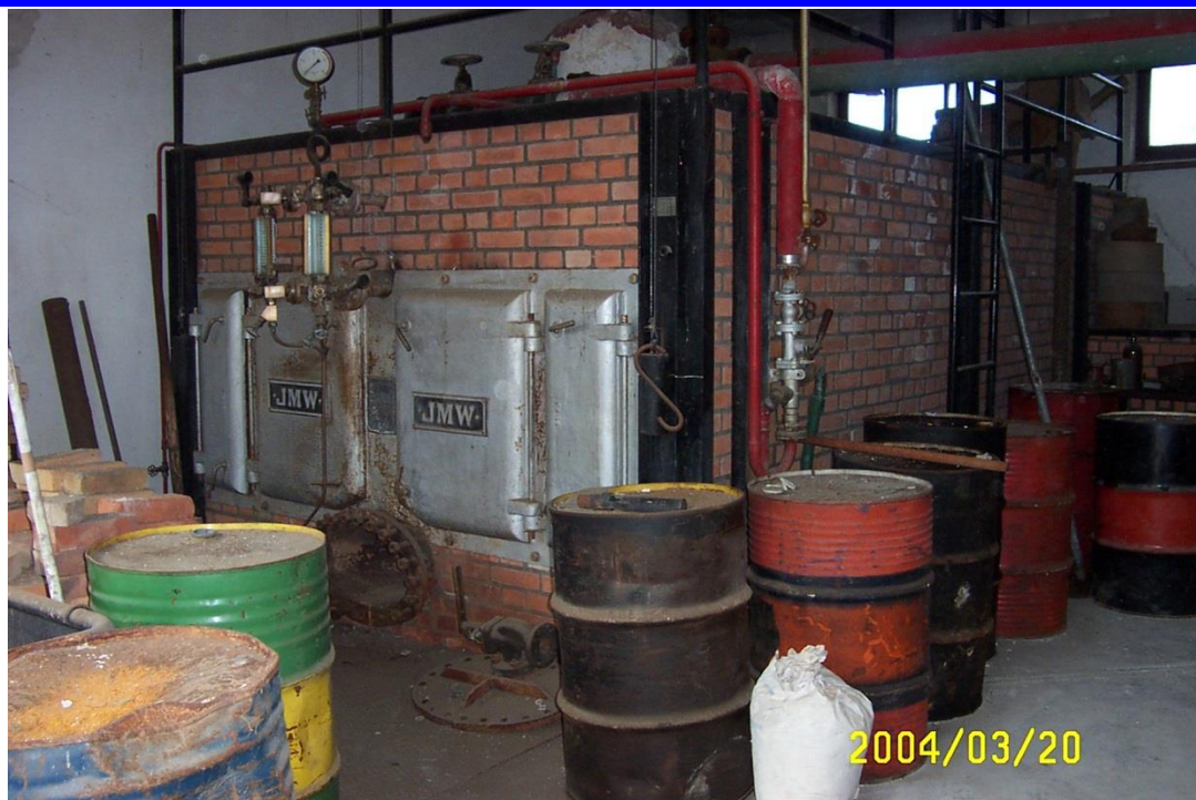
En undereldad tubångpanna tillverkad så sent som 1952 vid Jönköpings Mekaniska Verkstad. Pannan är eldad via förugn med sågverksavfall.
